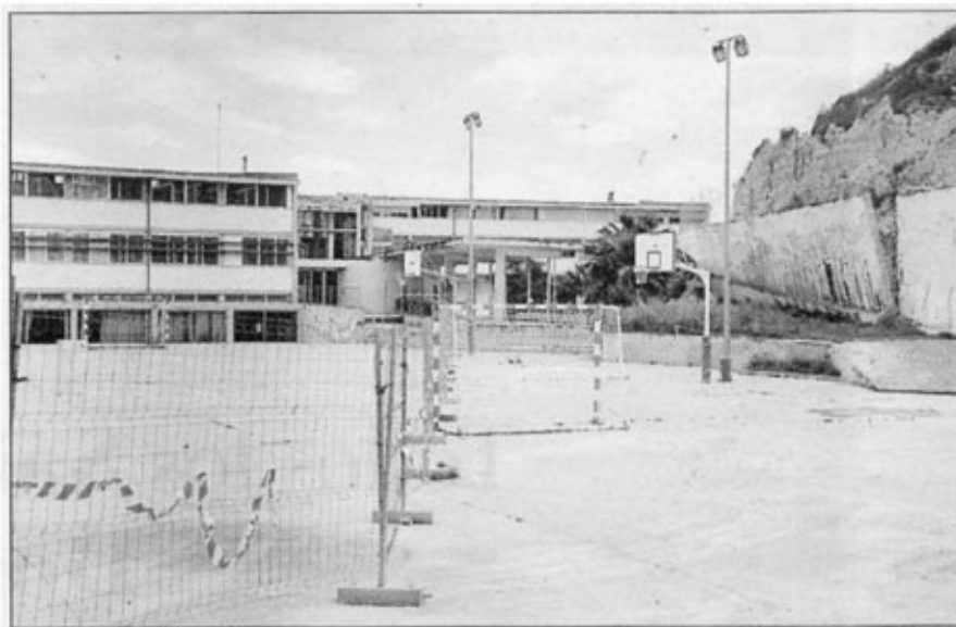
El patio, precintado, y al fondo, el muro dañado. FOTO: GUILLEM BOSCH.
